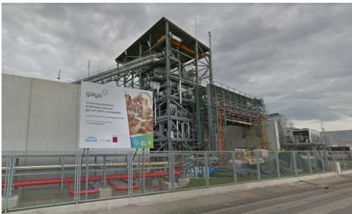
Ilustración 46. Proyecto Gaya. Planta piloto para valorización energética mediante gasificación.
